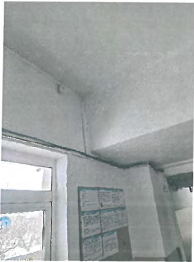
23. FISURI SALA DE CLASA
