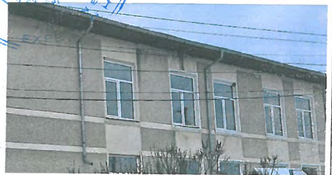
40. INFILTRATII ALE APEI+DISLOCARI DE TENCUIALA
