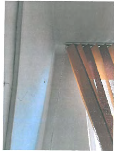
14. FISURI SALA DE CLASA
