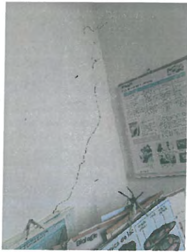
13. FISURI SALA DE CLASA
