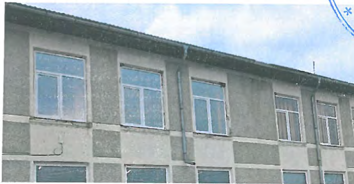
39. INFILTRATII ALE APEI+DISLOCARI DE TENCUIALA
