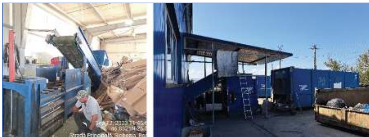
Figura 4-6 Presă balotat, presă și container transfer reziduuri Stație de sortare Roznov
